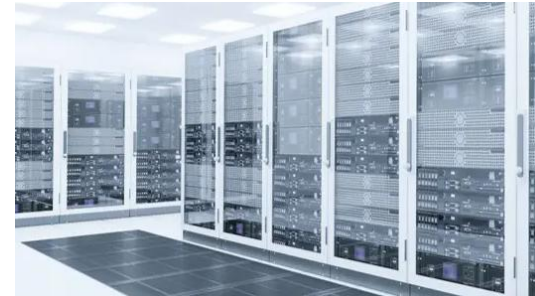
AIサーバ / データセンター
